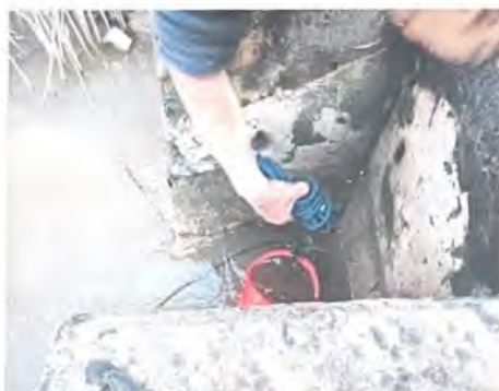
W2 雨水排放口
